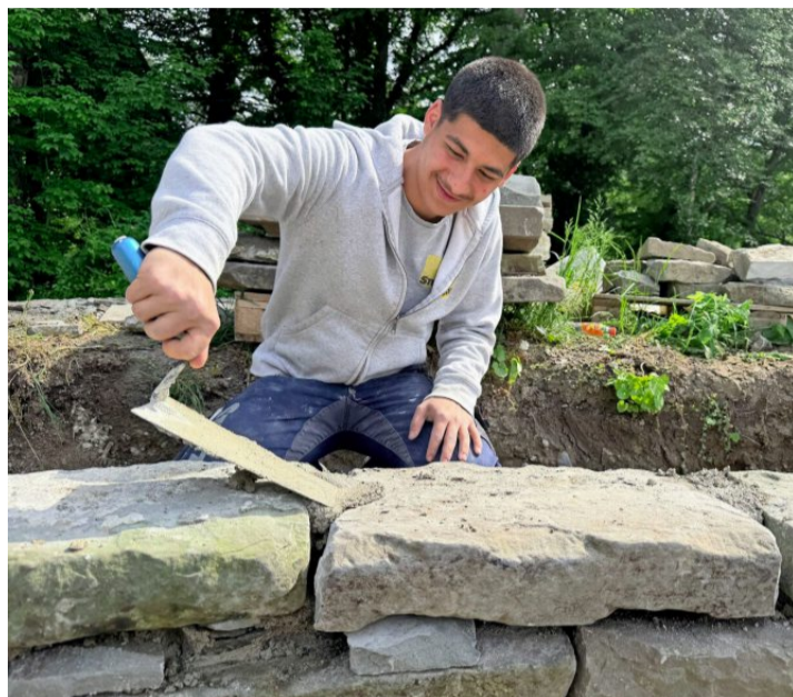
Der Maurer-Lernende Celilcan Taspinar beim Aufmauern der Sandsteine im Eingangsbereich der Ruine Sandegg. Bild: Werner Lenzin
